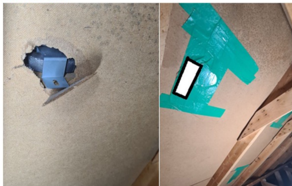
Kuva 44. Puhkottu katto ennen korjausta ja korjauksen jälkeen. Korjaus tehtiin vasta pyydettäessä. Kuva: Marko Ylinen
