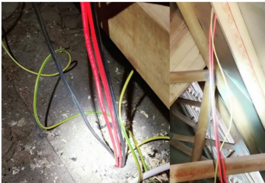
Kuva 43. Läpivientejä on tehty putkittamatta välikatolla, ja johdot ovat kiinnittämättä. Kuva: Marko Ylinen
