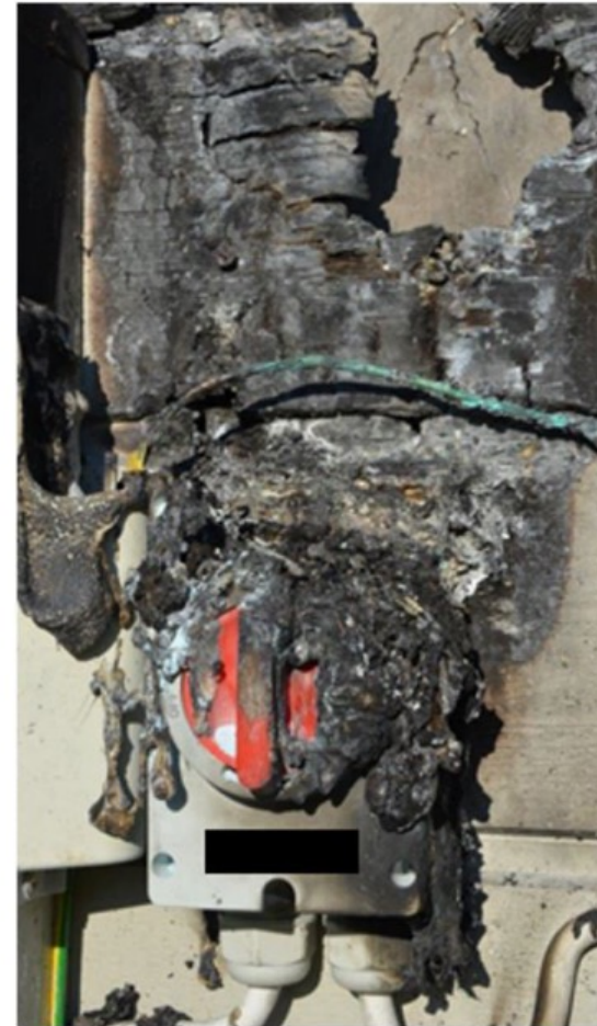
Kuva 45. DC-kytkin on sulanut kokonaan AC-kytkimen päälle. Kuva: Marko Ylinen
