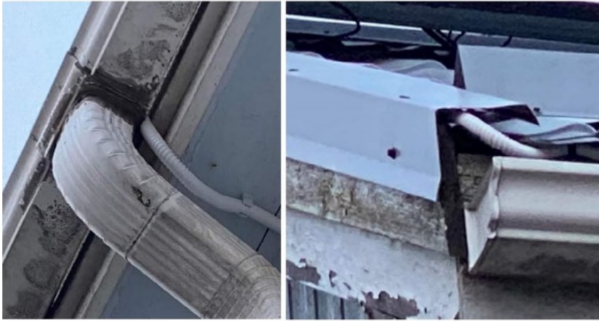
Kuva 42. Johtoja puristuksissa. Kuvan johdot on onneksi suojattu edes "kurkkuletkulla". Kuva: Marko Ylinen
