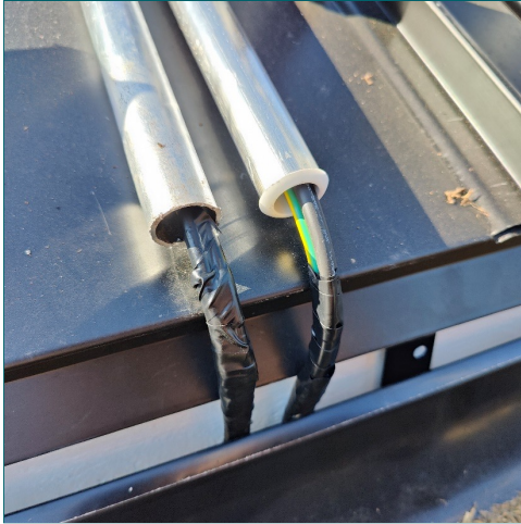
Kaapelit puristuksissa, putkenpäätä puuttuu
