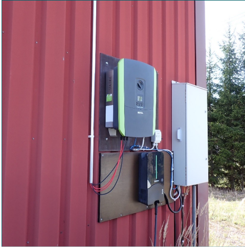
Invertteri asennettu palavalle alustalle
