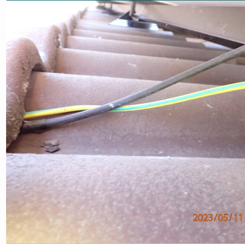
Kaapelit kiinnittämättä ja puristuksissa
