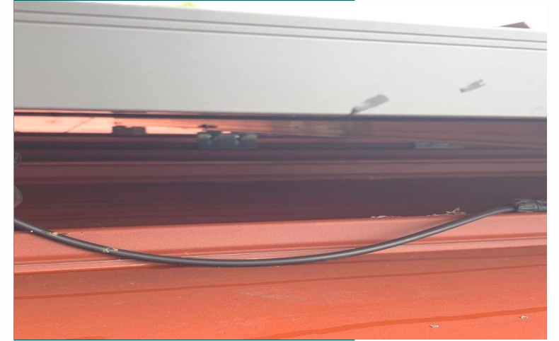
Kaapelit roikkuvat ja MC4-liittimet kiinnittämättä
