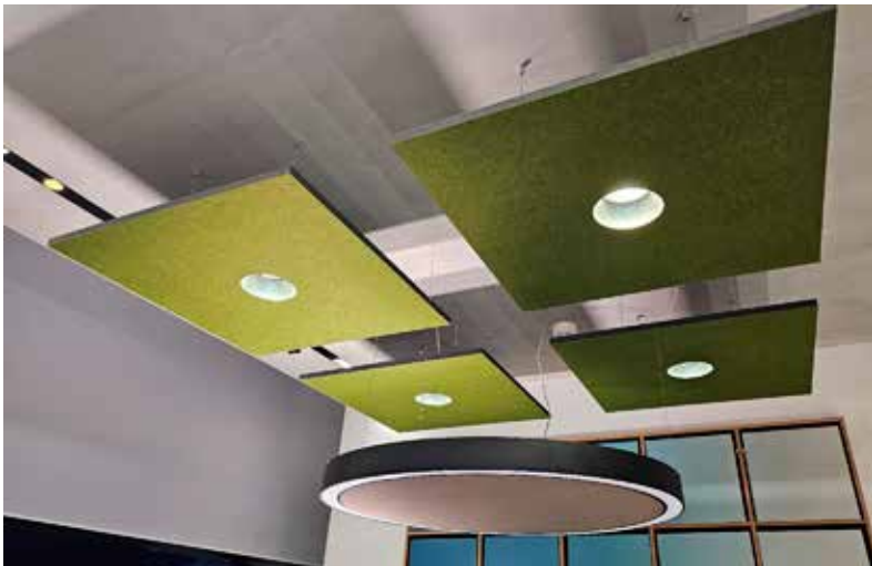
Akustoituja valaisimia. Upotettavat valaisimet ovat malliltaan Panos 3. Kuvassa pyöreävalaisimen malli on Ondaria
